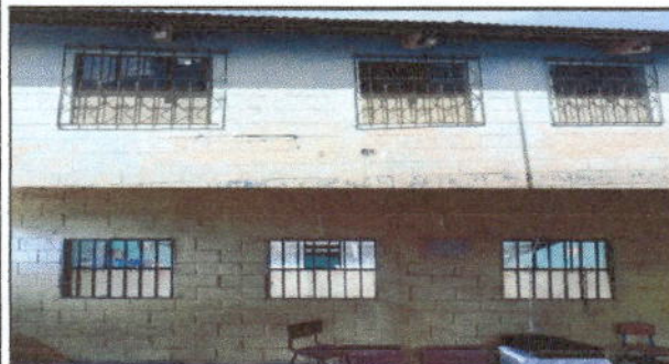
Foto 3: Se muestran fotos de las ventanas que hay que sustituir, las nueve ventanas tienen una medida de un metro cuadrado.
