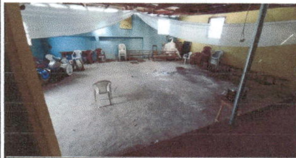
Foto 5: Se muestra fotografia del salon escolar que unicamente cuenta con una torta de concreto, sobre la cual se necesita colocar piso de granito para adecuar dicho ambiente a los niños y niñas
