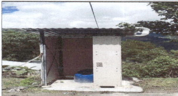
Foto 2: Se muestra la fotografia del baño que necesita la colocación de una nueva puerta, pues la que tenia se deterioró y se despegó.
