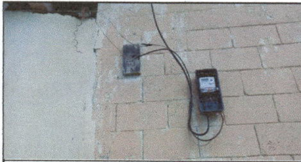
Foto 11: Se muestra el mal estado de todo el cableado electrico, iniciando desde la conexión principal con el contador hasta cada uno de los modulos, en cual se sustituirá en un 100%.
