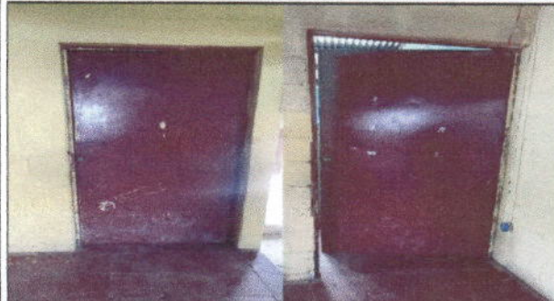
Foto1: se muestran fotografías de las dos puertas de las aulas que estan construidas desde 1,980 y por su deterioro ya necesitan ser sustituidas por puertas adecuadas. La puertas miden 1 metro por 2.10 metros
