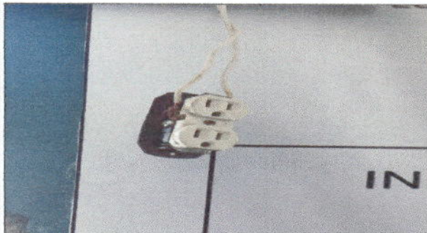
Foto 9: Se muestra el estado de los tomacorriente, los cuales se colocaran nuevos en todos los modulos.
