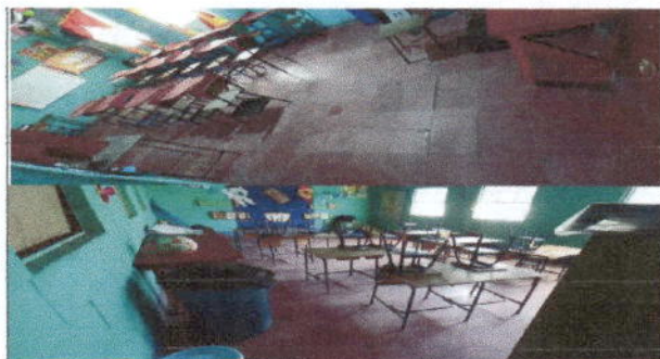
Foto 4: Se muestra las fotografías de las dos aulas, las cuales requieren el cambio de piso de granito, pues el que tiene actualmente se encuentra en muy mal estado.
